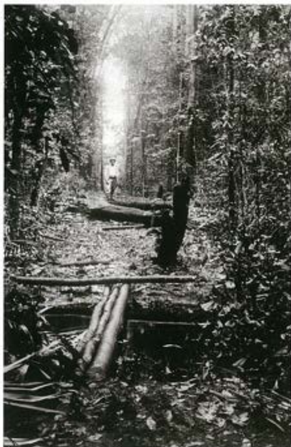
Het kappen van een tracé voor de aanleg van de spoorlijn, omstreeks 1907
